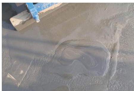
(c) 排泥に浮かぶ油膜
